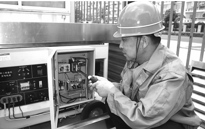
■图为庄培良在检查机电设备。
