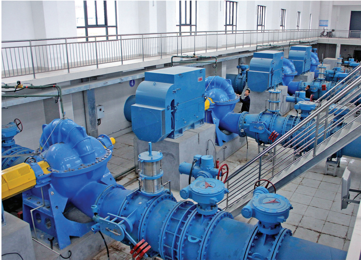
■惠南水厂工作人员正在新建的一期工程泵房,对试运行中的新装备设施进行巡视检查,以确保水厂正常运行。
